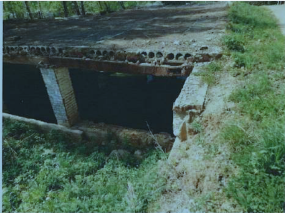
Фото 1 Отсутствие утепления или обваловки кровли
